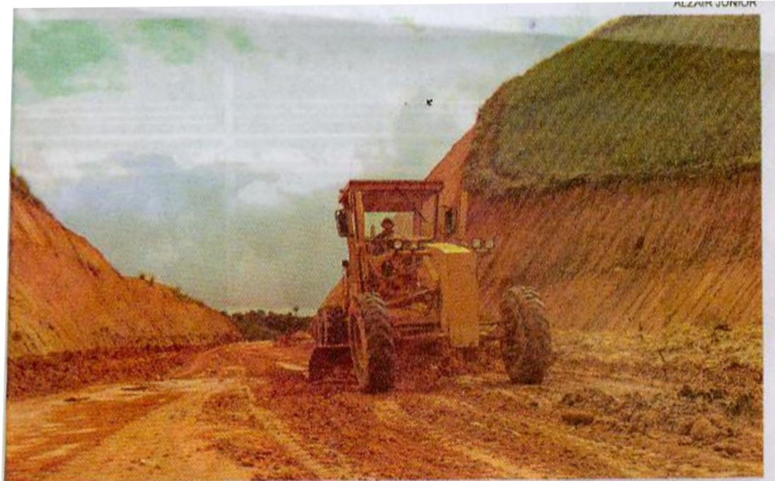
Obras de terraplanagem na área onde serão construídos três pontes e um viaduto na Flamenguinha
